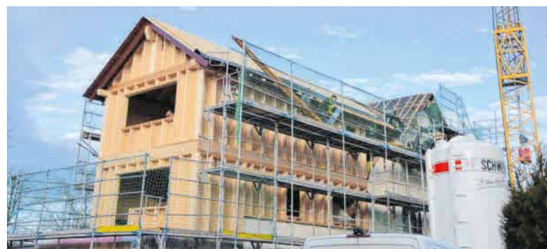
Ein Jahr lang wurde der Gasthof aufwendig saniert und ausgebaut. Die große Baustelle, die im Januar zu sehen war, ist bald ganz verschwunden. Nun fehlen nur noch die Gäste. ARCHIVFOTO: SILJA MEYER-ZURWELLE
